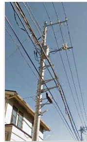
▲柱状変圧器イメージ
