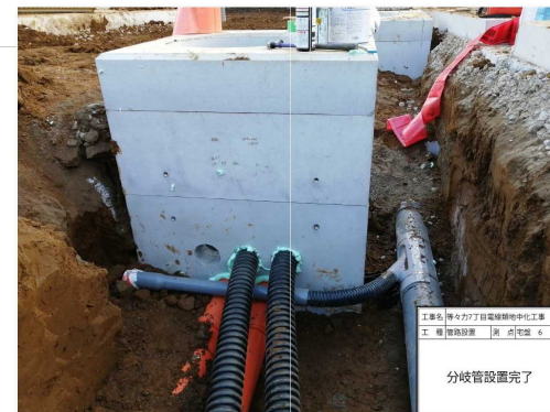
▲ 枹からの分岐状況
