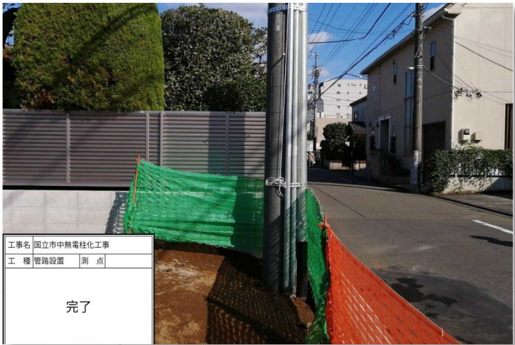
▲ 立ち上げ管路状況
